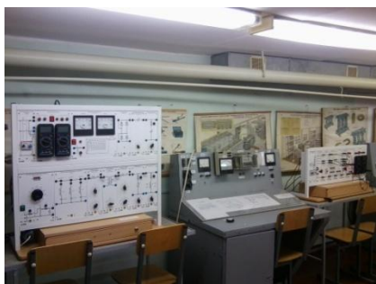
Кабинет 1 корпус «В». Лаборатория силового электрооборудования, кабинет электроснабжения
